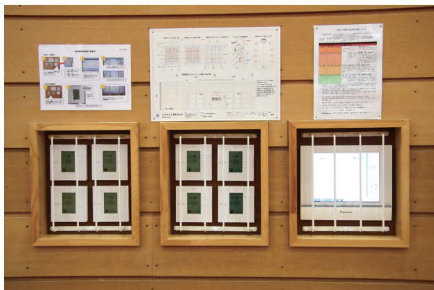
▲空調設備操作パネル（米沢小学校）
