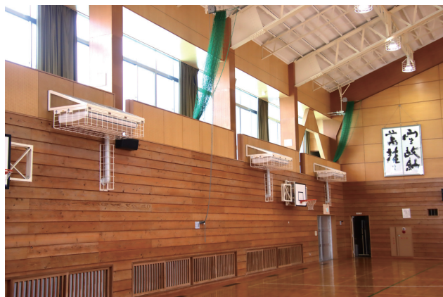
▲設置した空調設備（神崎小学校）
