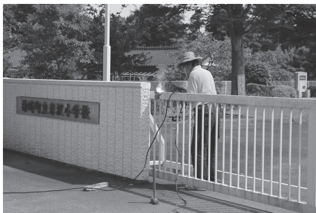
亀裂が入った正門を溶接する（米沢小）
