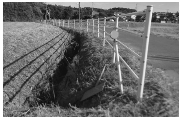
神宿地先に設置された転落防護柵
