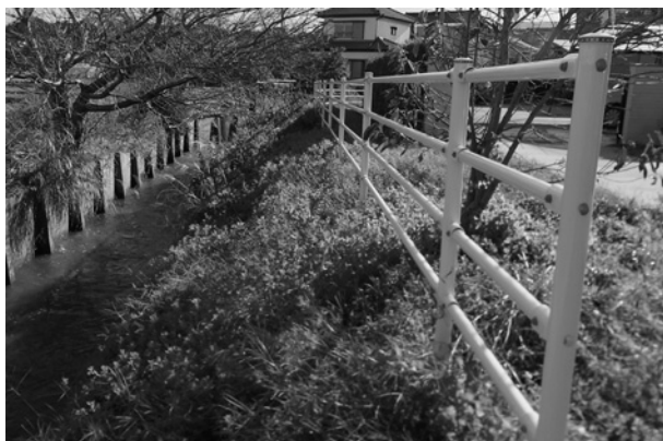
本宿地先に設置された転落防護柵
