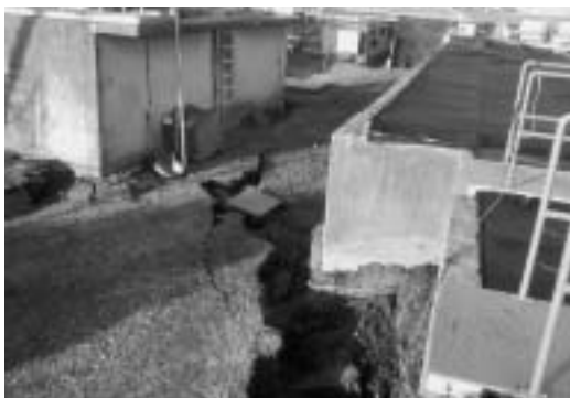
被災した神宿浄水場
