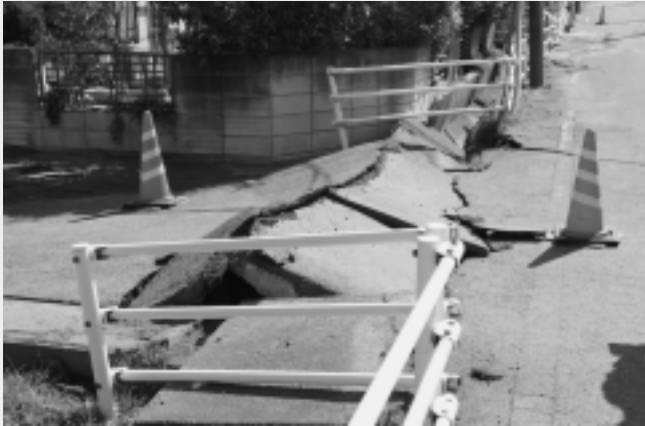
めくれ上がる道路
