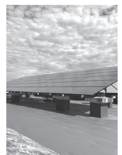
太陽光パネル
