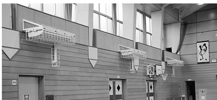
小学校体育館に設置されたエアコン
