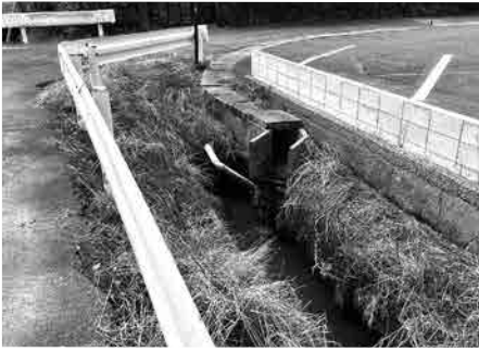
転落防止用のガードレール
