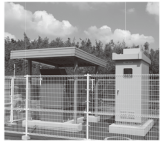
役場から神崎小学校へ 移転した発電機
