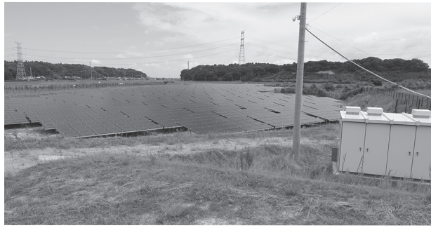
再生可能エネルギーの代表太陽光発電パネル
