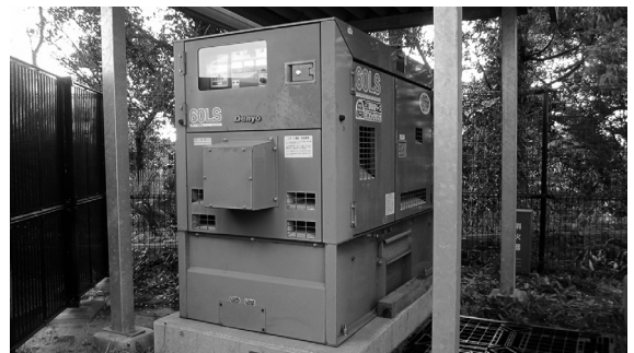
既存の発電設備(役場)
