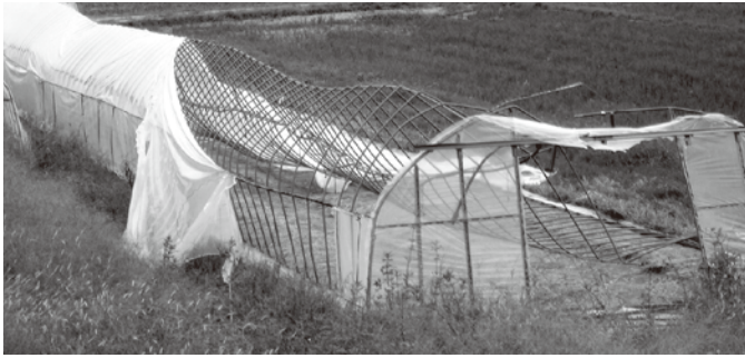
倒壊したビニールハウス
