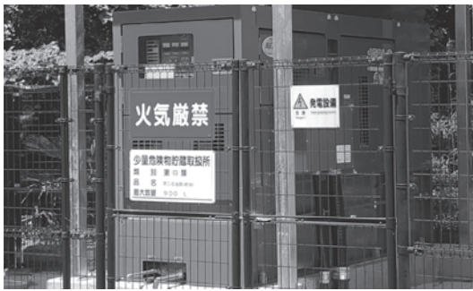
非常用発電設備
