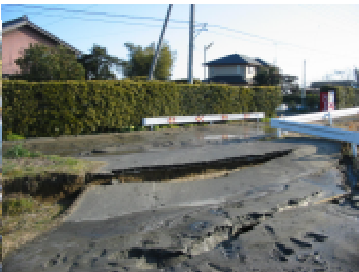
液状化及び道路陥没
