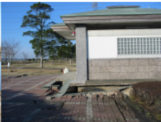
天の川公園トイレ液状化による隆起
