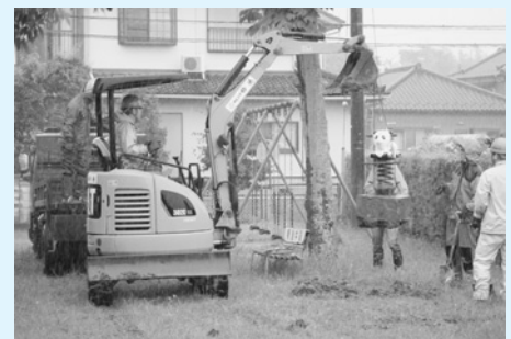
プラザ脇の危険遊具を撤去
