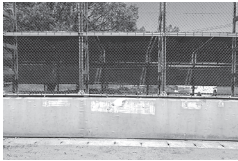
破損箇所が目立つバックネット
